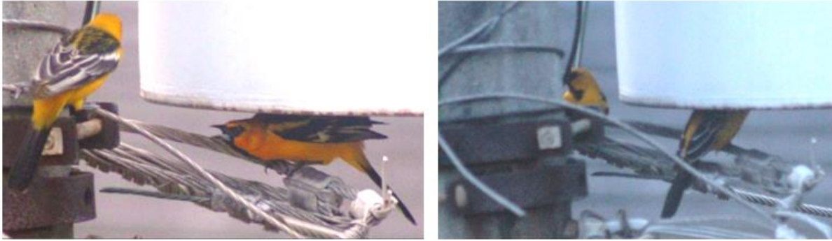
Figura 23. Pareja de Chiltotas de espalda rayada ( Icterus pustulatus ) usando un transformador como dormitorio y protegerse de la lluvia.
